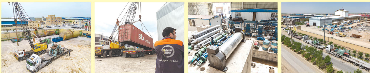
ورود ماشین آلات و ادامه روند احداث کارخانجات نورد سرد صنایع فولاد شهریار تبریز
